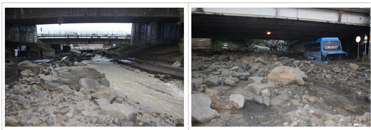
Figura 7.47 – Impatti dell'evento di settembre 2009 all'altezza dell'attraversamento della SS 114 sul torrente Sillemi nel Comune di Letojanni (ME) – Fonte: Ufficio Tecnico Comune di Letojanni.
